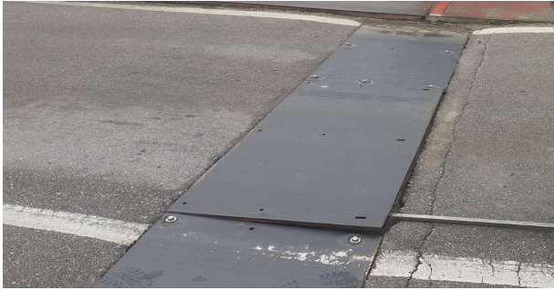
Desplazamiento vertical de una pieza de junta metálica
