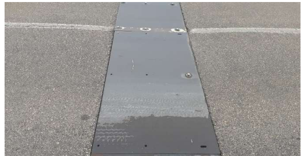
Junta metálica: se conserva un tornillo de los nueve iniciales
